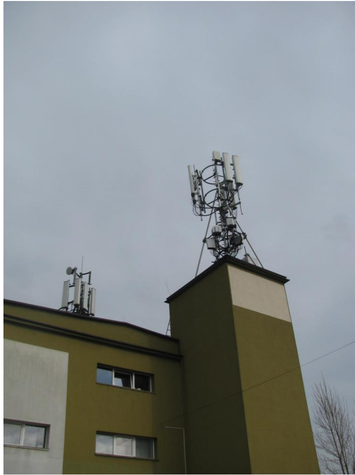
Zał. nr 1: Widok ogólny instalacji radiokomunikacyjnej.
